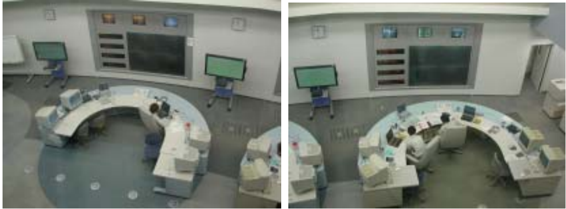
圖 10 磯子發電廠機組控制室
