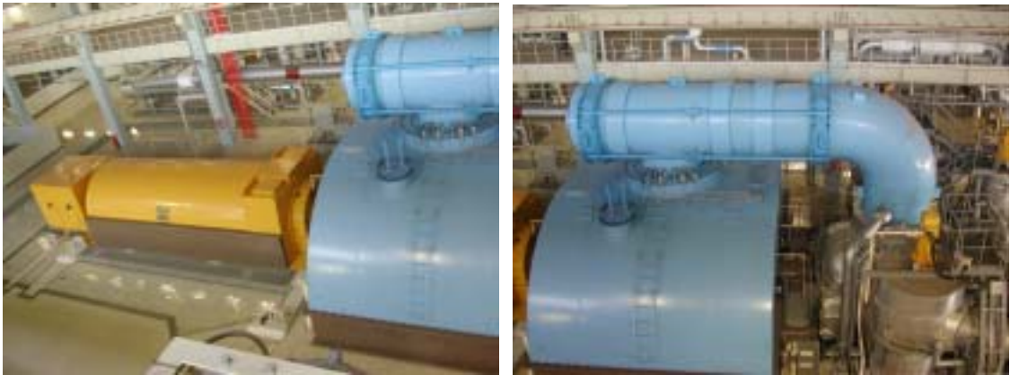
圖 5 磯子發電廠發電機組
