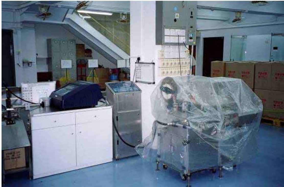
圖七十：保心安藥廠儀器廠房設備
