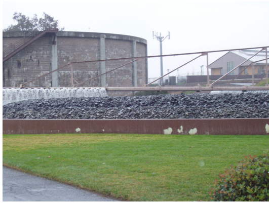
污水處理設備
