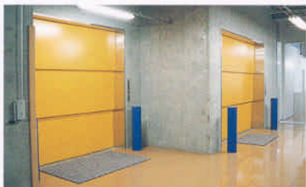
■荷物用エレベーター Elevator for freight
