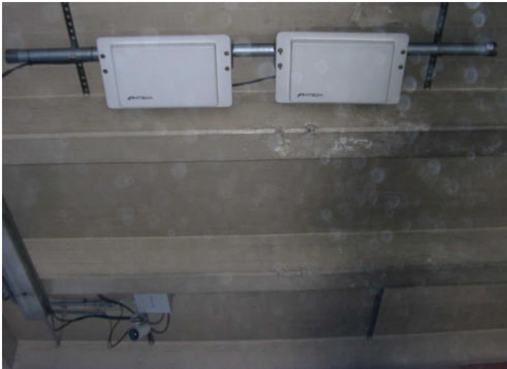
電子收費設備
