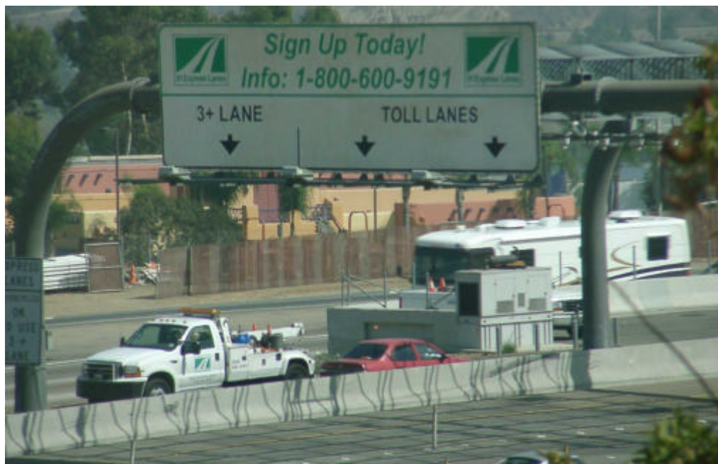
電子收費設備
