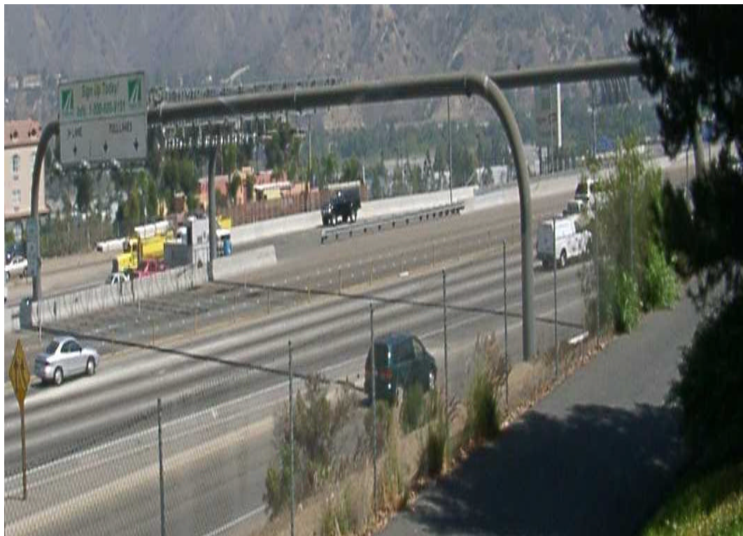
電子收費設備
