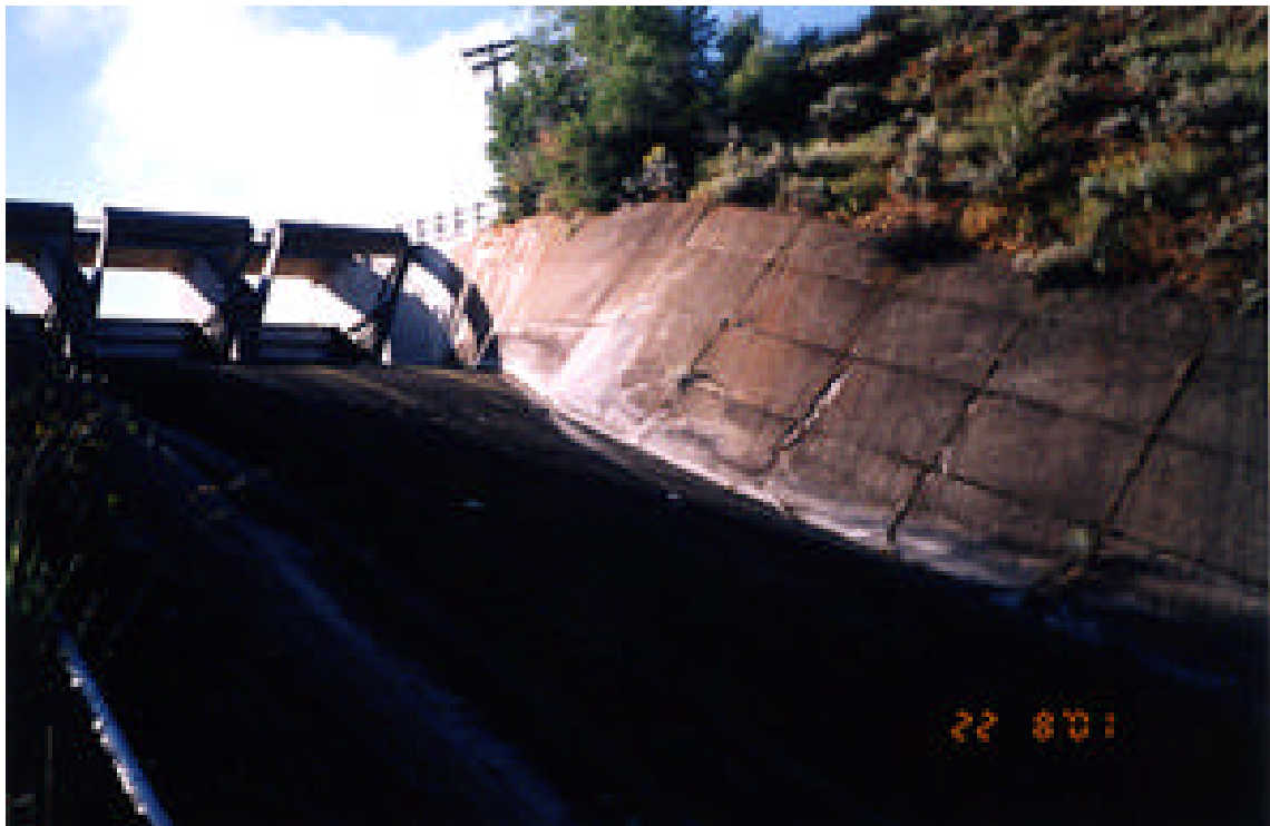
Echo Dam 溢洪道側牆混凝土龜裂情形
