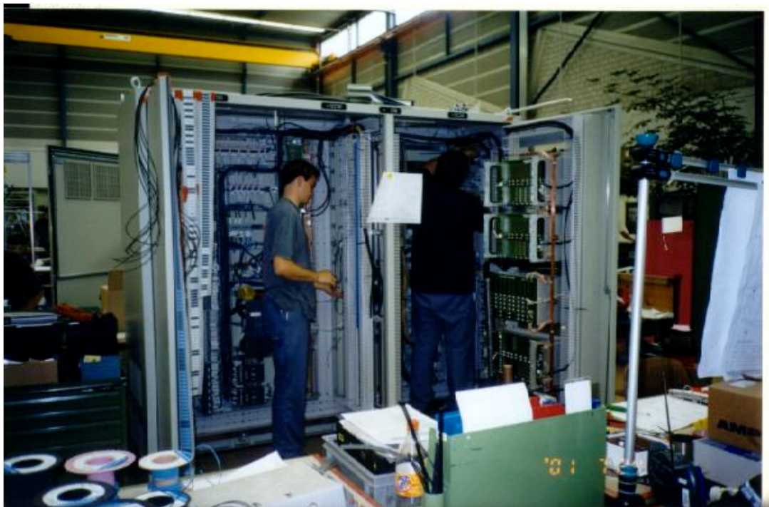
#2Excitation Cubicle 之 Power Converter 配線。
