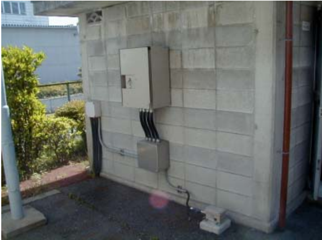
照片五：整壓站控制元件及地震計裝置面
