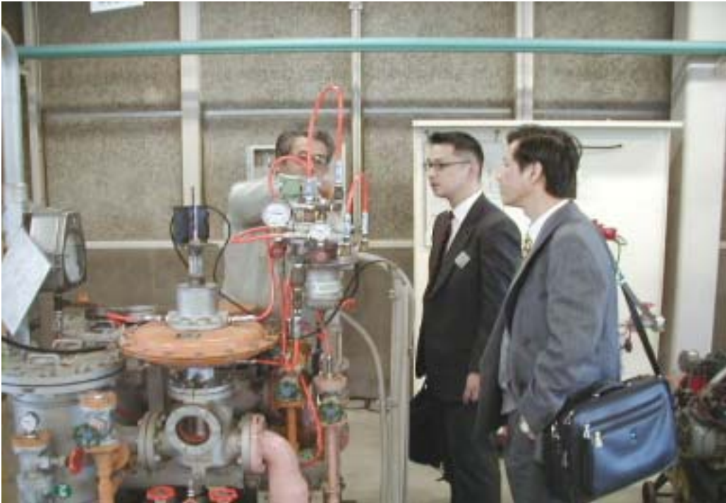
照片一：大阪瓦斯公司人員講解整壓器系統
