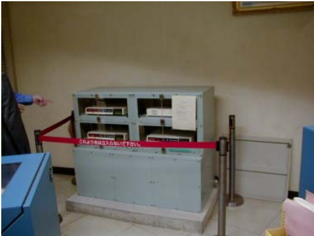
照片八：根岸煉油廠潤滑工場裝置地震計
