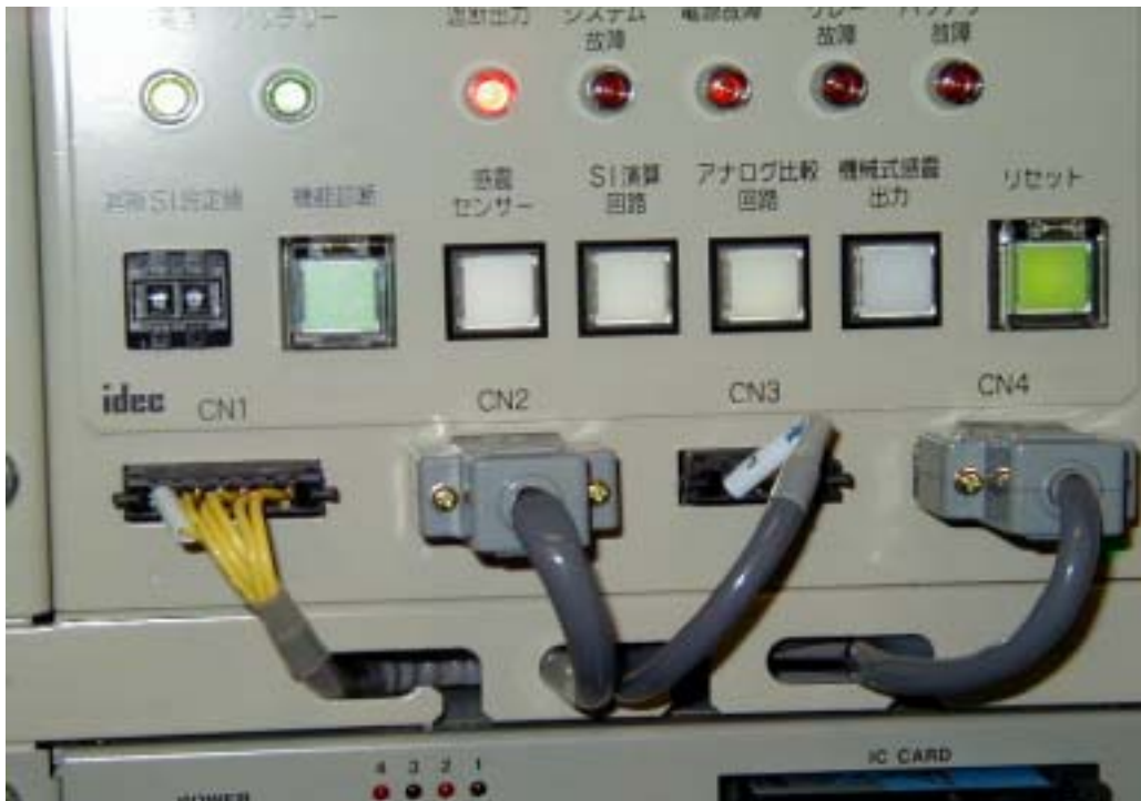
照片四：整壓器控制面盤指令單元
