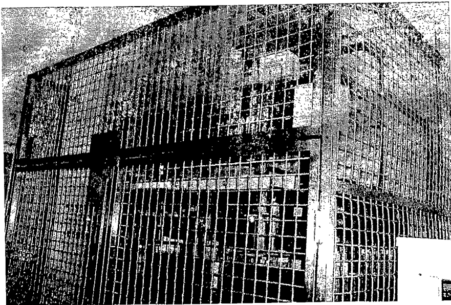
圖二十四 短路設備用變壓器
