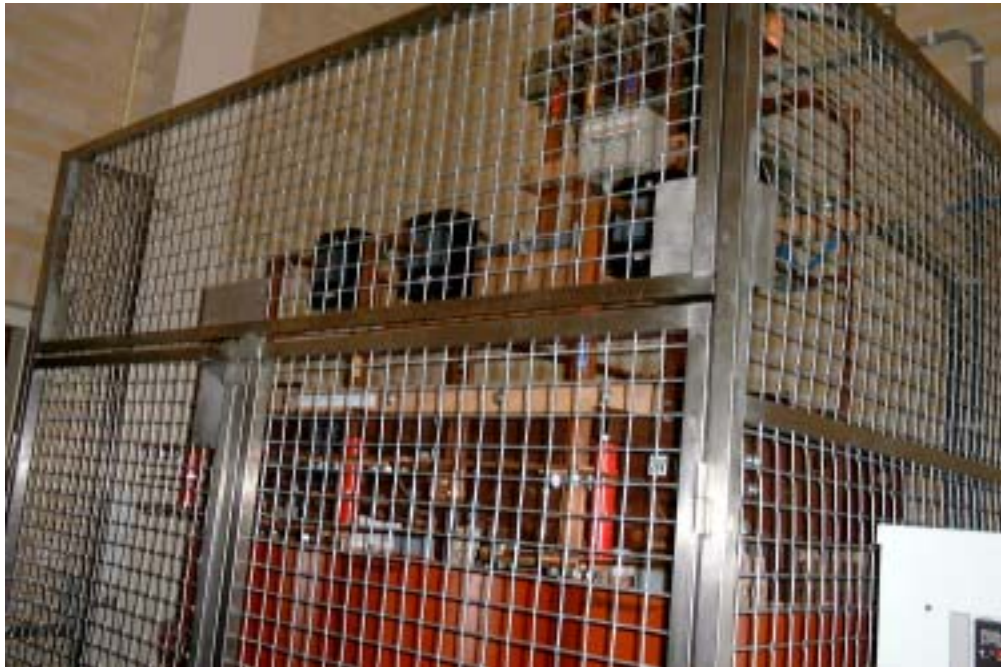
圖二十四 短路設備用變壓器
