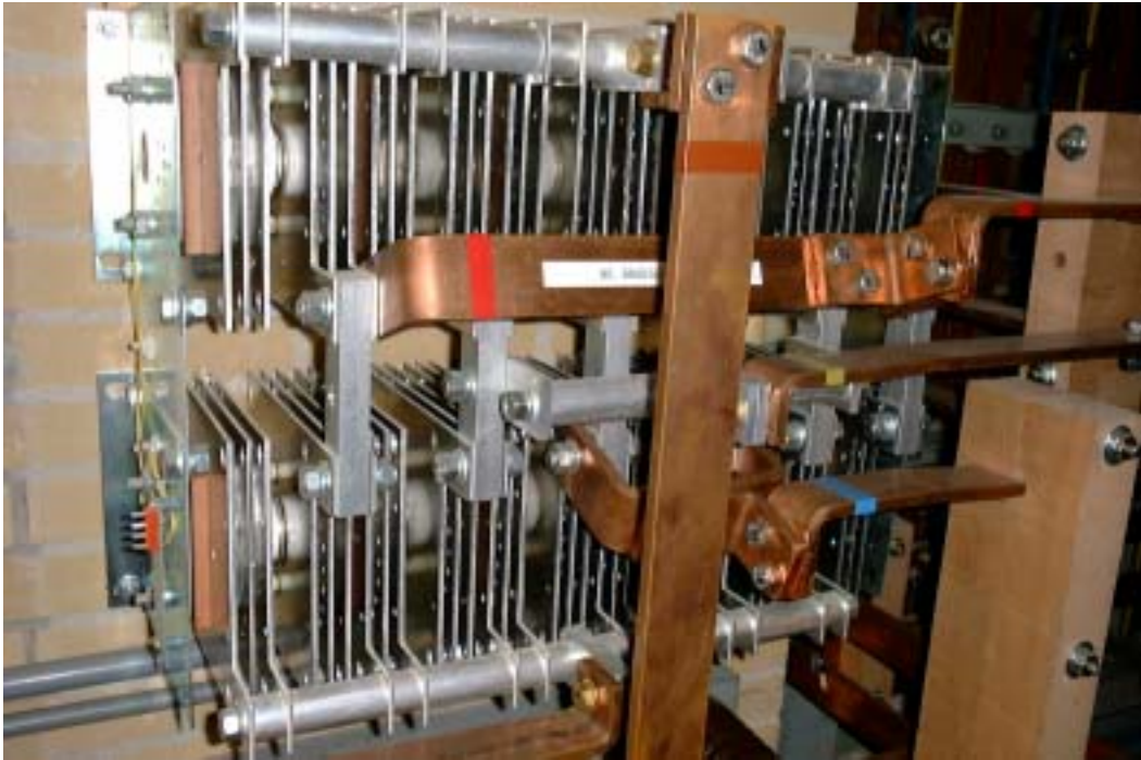
圖二十七 短路設備-直流電源整流器
